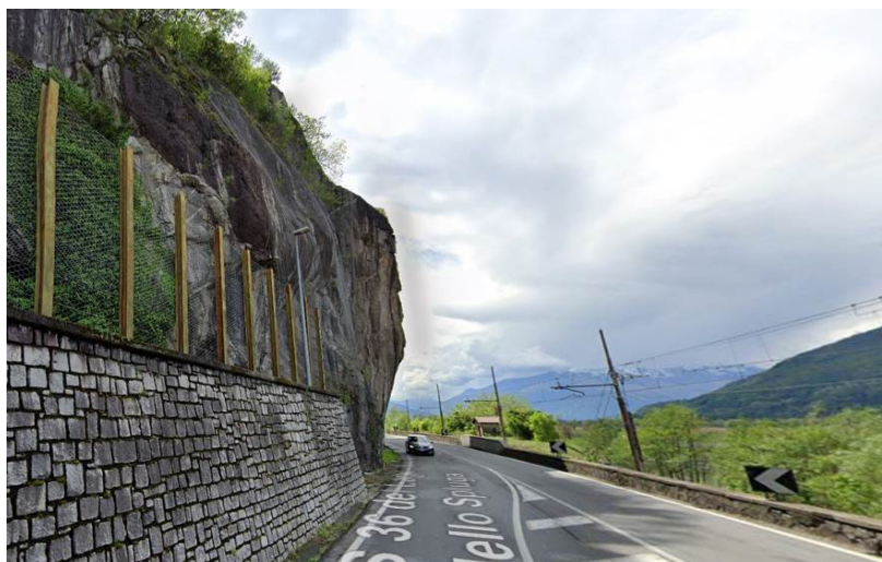
Opere di protezione del versante a monte della SS36 al confine con il comune di Dubino (SO) (estratto Google Maps)
